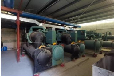
中央空调设备
