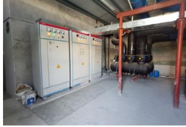
中央空调设备
